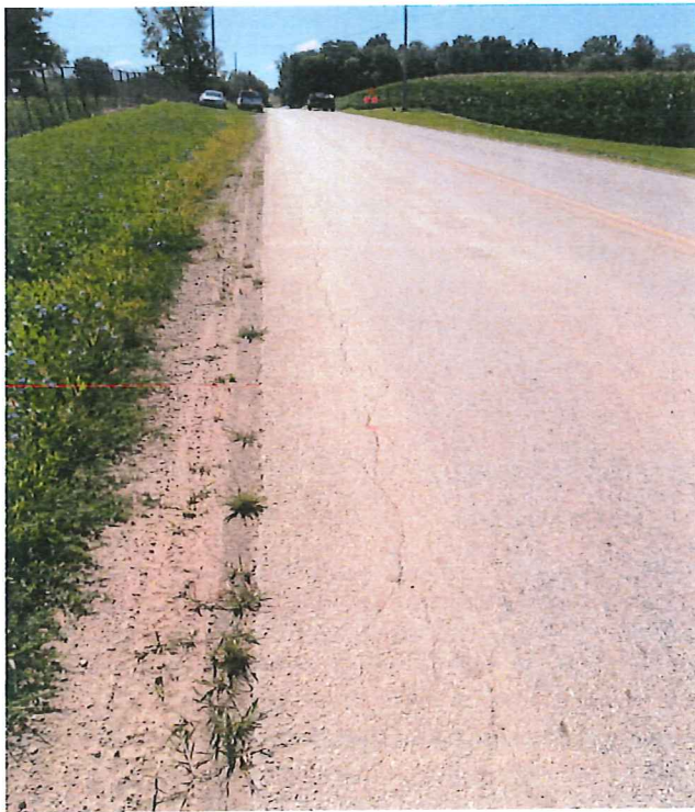
Longitudinal and edge cracking.
